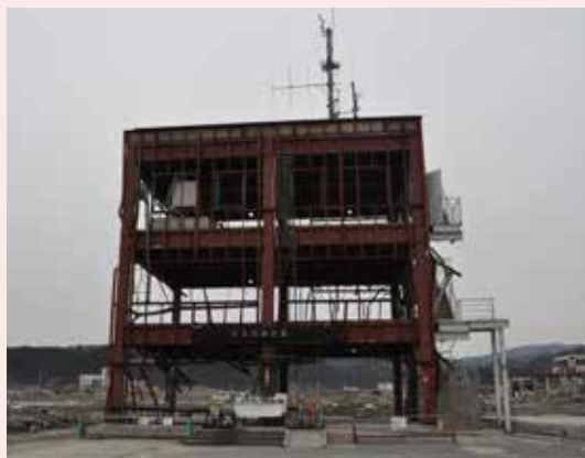
東日本大震災の津波で骨組みだけとなった南三陸町の防災対策庁舎。近く取り壊される予定。「(保存は)つらい記憶が蘇る」という地元の方の意見もありました。(2011年12月8日撮影)
